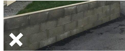
Muret non enduit en façade
